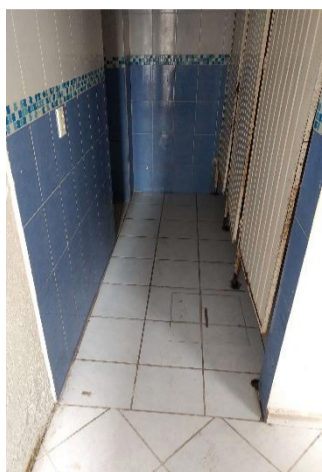
Sanitario (gabinetes de inodoros) – Presidencia Municipal
