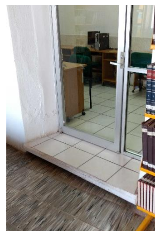
Desnivel en acceso a sala de cómputo – Biblioteca Pública
