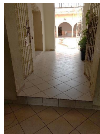
Desnivel en pasillo de acceso a Casa de la Cultura – Presidencia Municipal
