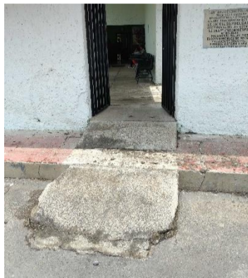
Rampas en guarnición y en puerta exterior – D.I.F. Municipal
